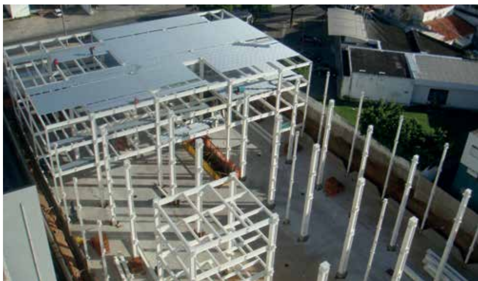
A estrutura em aço utilizada no edifício possibilitou a execução de vãos maiores entre os pilares, bem como a redução da altura das vigas em até 30%, se comparada a uma estrutura de concreto convencional
